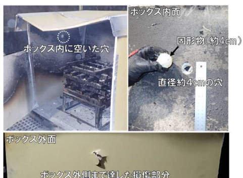
図 20 ボックスの損傷状況及び白色固形物
