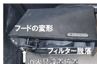
図 22 衝撃により破損したレンジフード
