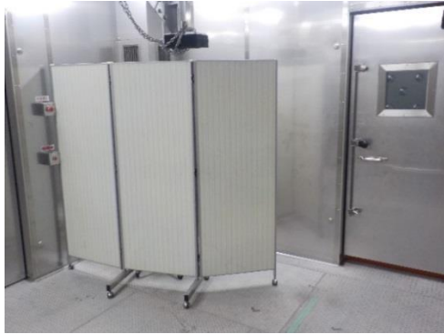
写真1 パーテーション設置状況
