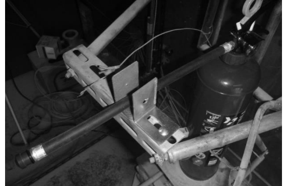
図6 ノズル振幅固定金具
