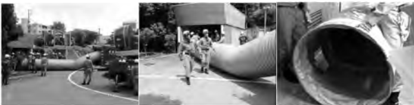
写真4 3HCX送風管の送風口位置、及び6HSW2送風位置
