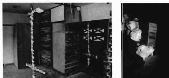
写真5 居室内の可燃物設置状況 写真6 階段室の可燃物設置例
