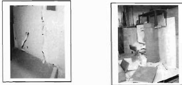
写真 25 加振後の石膏ボード 写真 26 加振後の冷蔵庫
