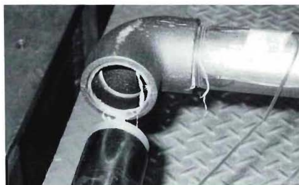
写真7 結合部の切損状況
