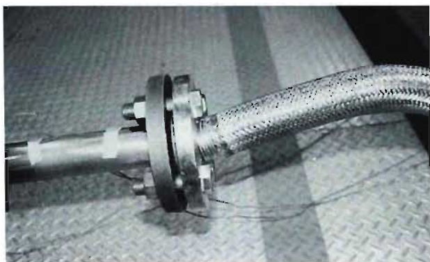
写真6 フレキシブル管の破損状況
