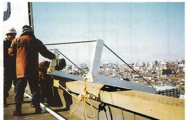
写真5 突りょうが前のめりとなった状態
