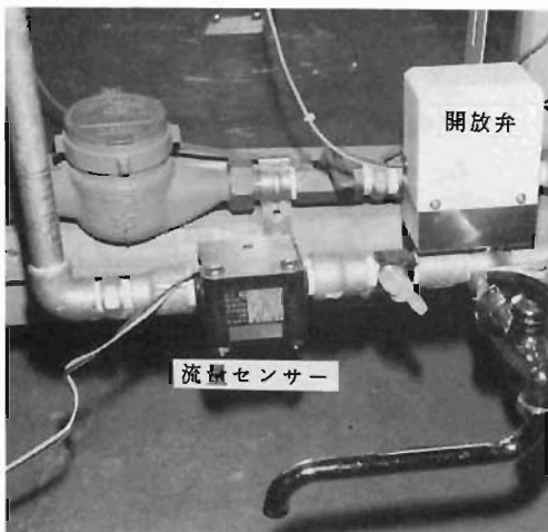
写真3 開放弁及び流量計センサー
