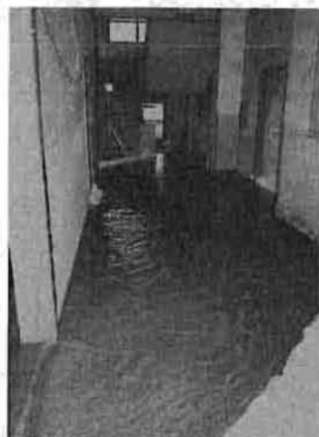
写真28 廊下を階段に向かって流れる消火水
