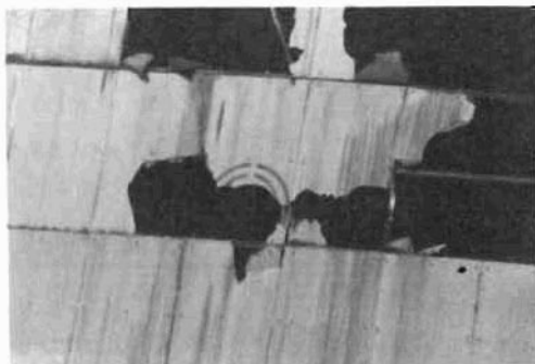
写真2 壁体の破壊状況 (4100 ℓ/min 地上高約10m)
