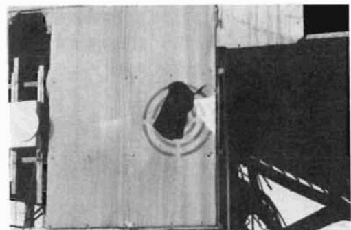
写真4 壁体の破壊状況 (2950 ℓ/min 地上高約3m)
