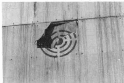
写真3 壁体の破壊状況 (2820 ℓ/min 地上高約6m)
