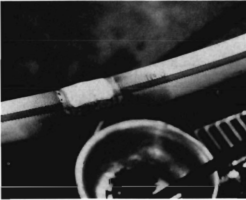
写真4 パッチ周辺へにじみの状況(着色水)
