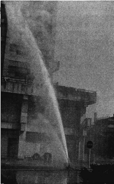
写真1 自動水幕装置
