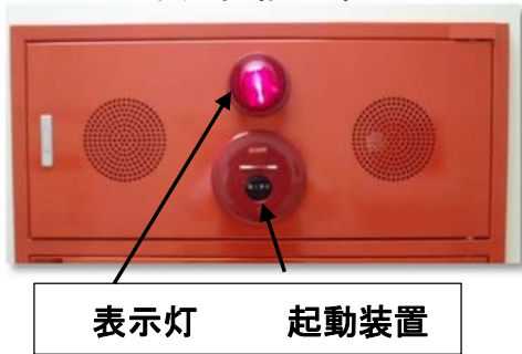
《消火栓箱上部》
