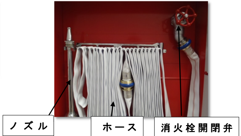
《消火栓箱内部の扉を開放した状況》
