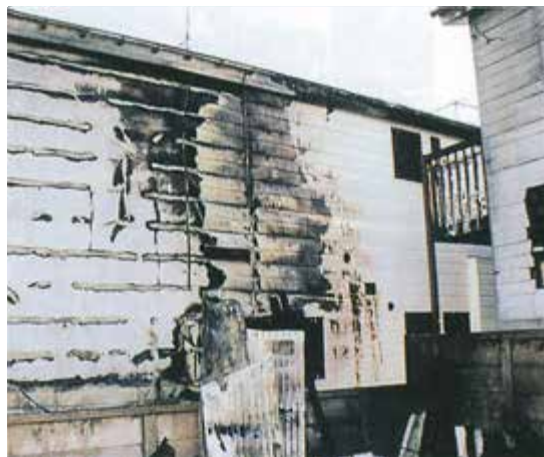
焼損部分の撮影
