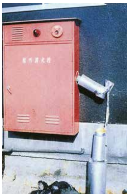
屋外消火栓設備の被害例
