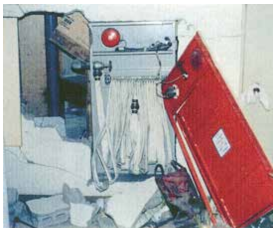
屋内消火栓設備の被害例
