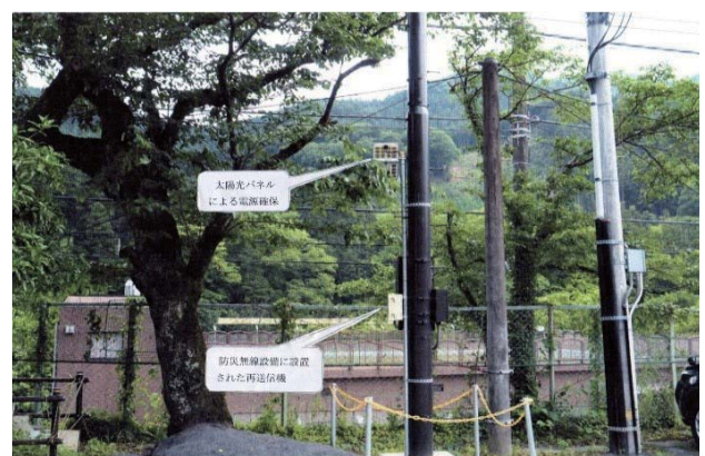
防災無線設備に設置された再送信機
