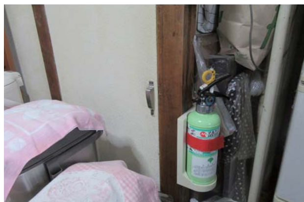
全住戸に住宅用消火器を配置
