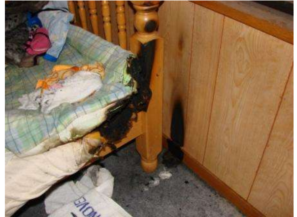
写真1-2 周囲の焼損状況
