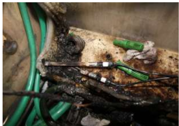
写真2-2 観賞魚用ヒータの状況
