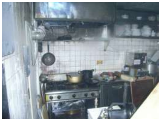
写真1 出火した厨房の状況
