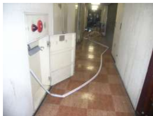
写真2 使用した屋内消火栓の状況
