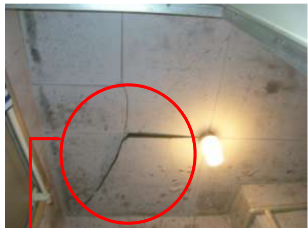
本火災の爆発による破損箇所
