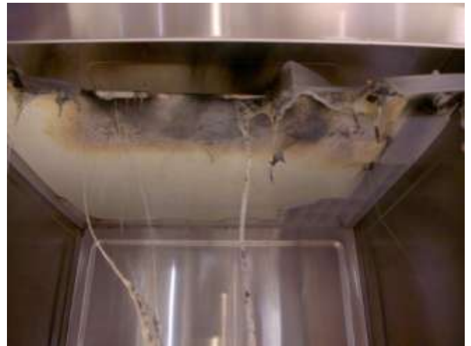
写真 2-2 焼損した庫内の状況
