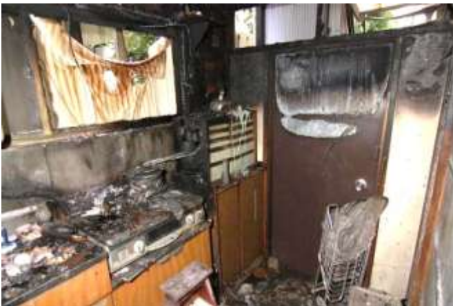
写真 1-1 出火室の状況
