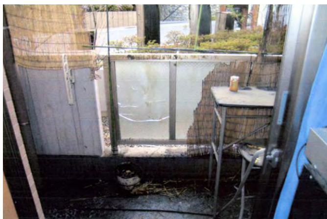
出火したベランダ～すだれなどが燃えている
