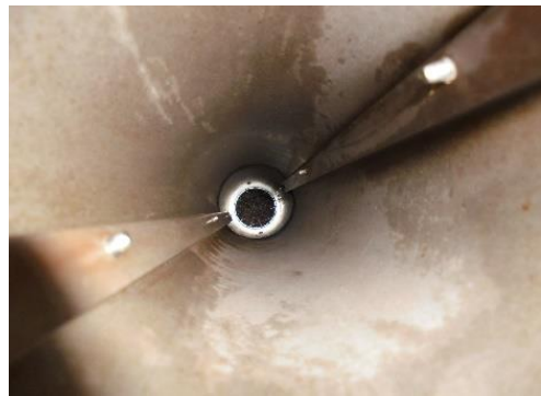
写真5-21 店舗G 上引きダクト
