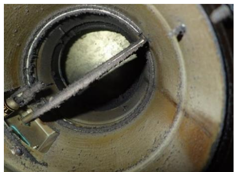
写真 5 - 6 店舗 A 防火ダンパー
