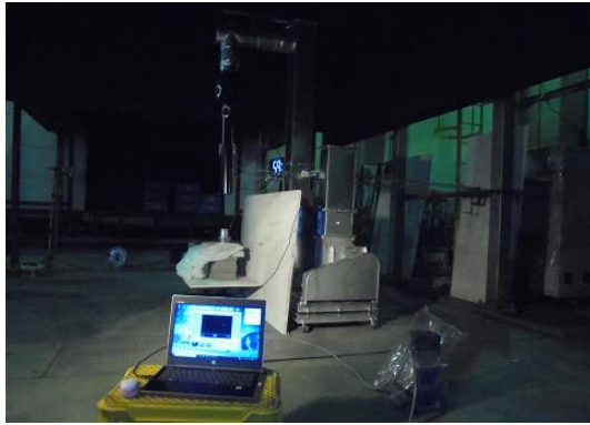
写真6-93 上引きダクト内部カメラ モニタリング
