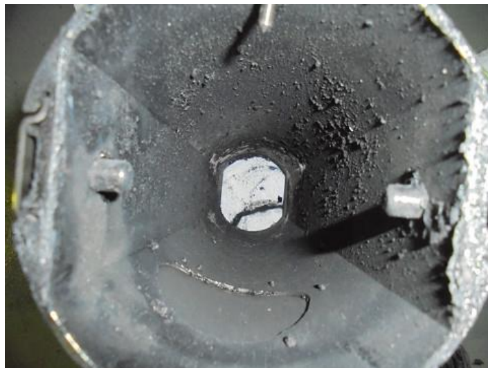
写真5-12 鎮火後、ダクト内部の状況（着火有）
