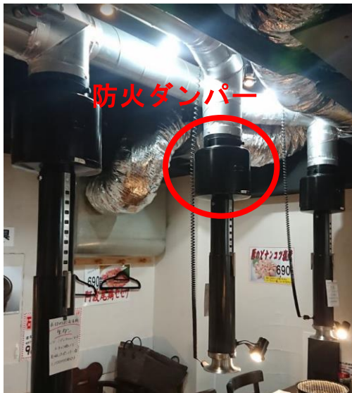
写真 5 - 2 防火ダンパー
