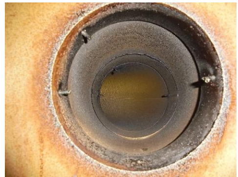
写真5-20 店舗F 枝ダクト
