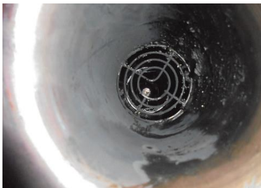
写真6-120 着火後のダクト内部 吸込み口
