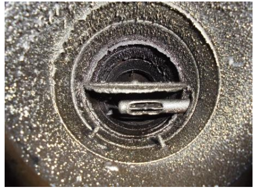
写真5-17 店舗E 防火ダンパー
