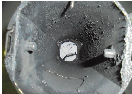
写真6-119 着火後のダクト内部 固定ダクトを上方より撮影
