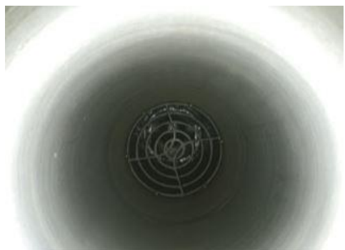
写真5-10 店舗C 上引きダクト
