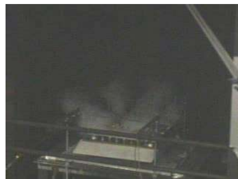
消火剤放出後の様子
