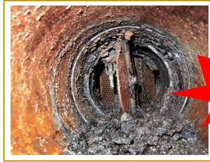
ダクト内の下部に溜まった油かすが焼損した状況 ダンパーは作動していない
