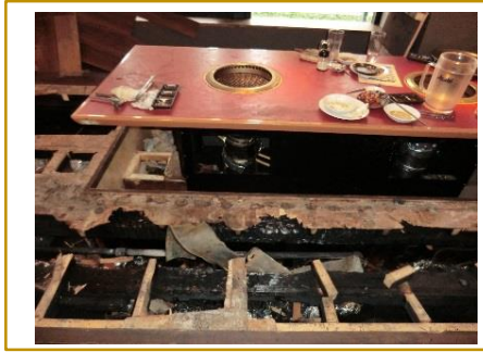
客席内下引きダクトが焼損した状況
