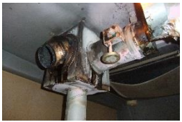
焼損したダクトの外観
