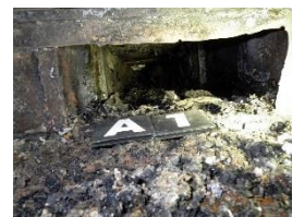
焼損したダクトの内部
