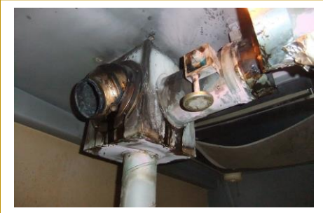
焼損したダクトの外観
