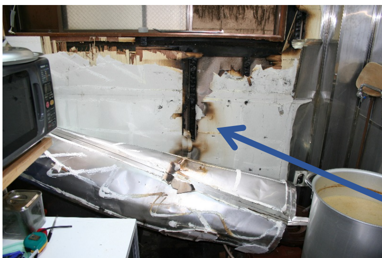
ステンレス板をはがした内部の状況
