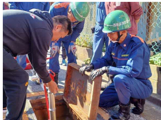
実際の消火栓に接続
