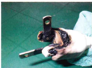
変形したプラグの無理な差し込みにより片刃が発熱し焼損
