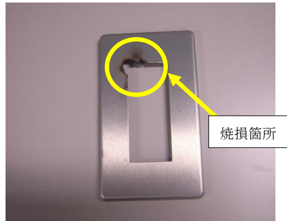
写真3-2 コンセントカバーの焼損状況
