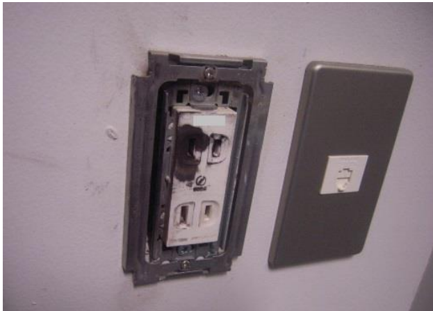
写真3-1 コンセントの焼損状況
