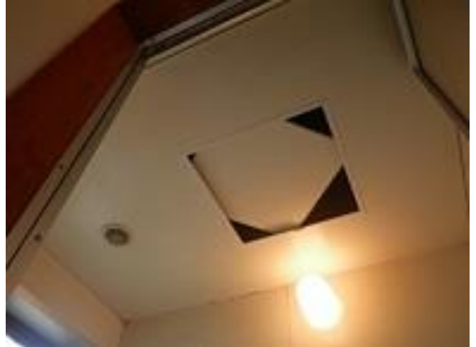
写真2-2 点検口の破損状況
