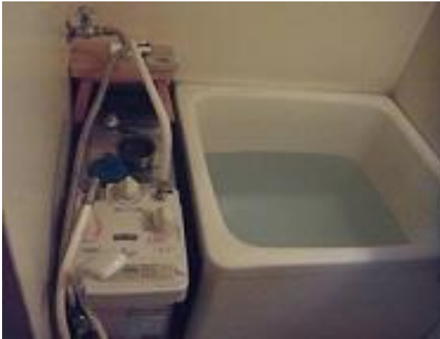
写真2-1 出火したの浴室の状況
