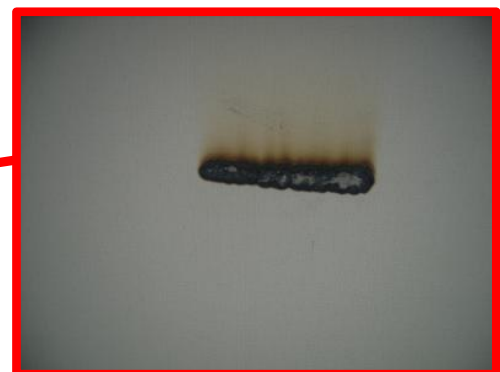
焼損箇所拡大
