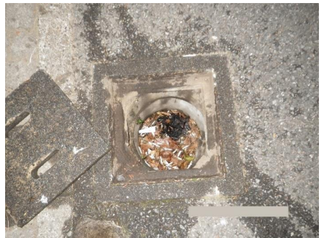
写真11 排水柵内部の焼損状況
