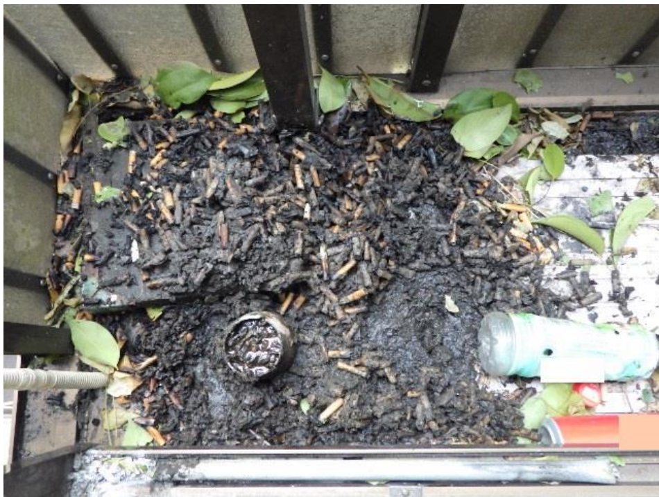
写真3 ベランダの焼損状況
