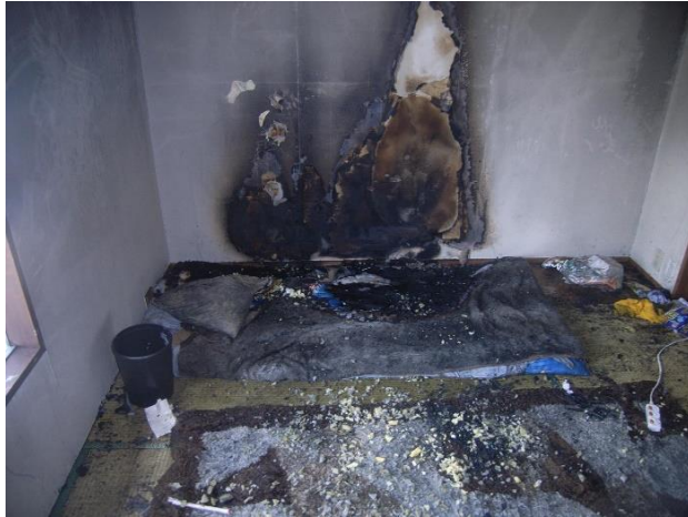
写真1 居室の焼損状況
