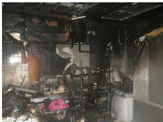
写真1 台所の焼損状況
