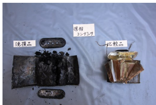
写真2 低圧進相コンデンサの焼損状況
