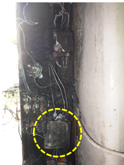
写真3 動力用分電盤の状況
