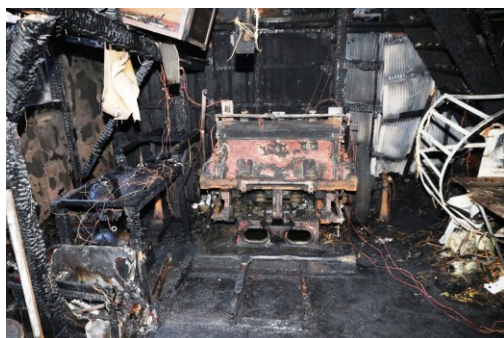
写真1 低圧進相コンデンサが設置されていた箇所の状況
