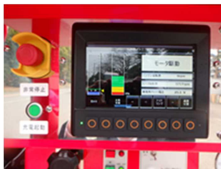
消防ポンプ補助装置操作パネル
