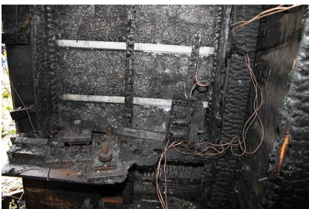
写真1 動力用分電盤の状況
