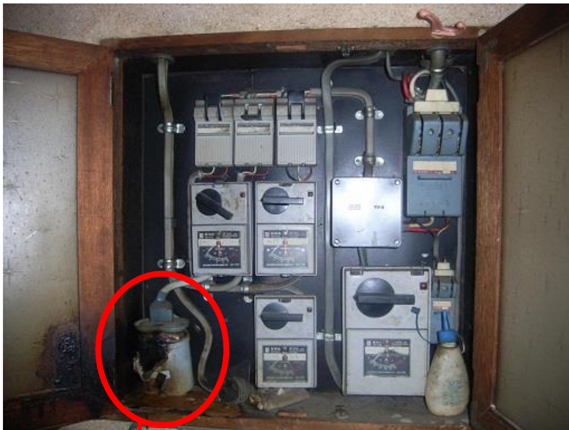
分電盤の低圧進相コンデンサ設置例
