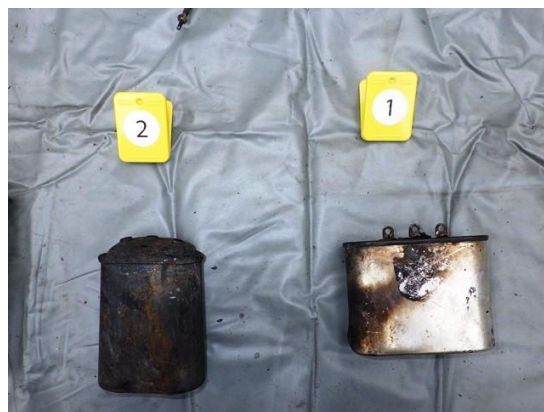
写真2 低圧進相コンデンサの焼損状況
