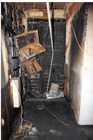
写真3 動力用分電盤の状況
