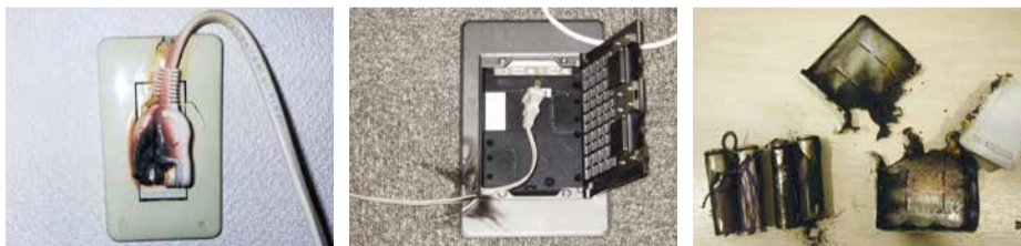
コンセントに差した状態で焦げたプラグ
