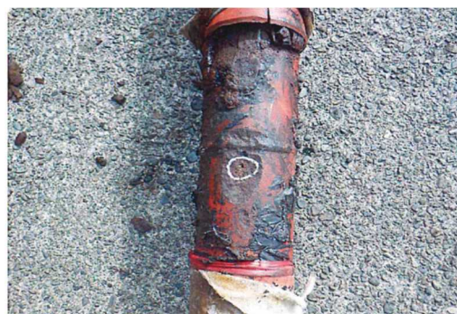
配管の腐食状況
