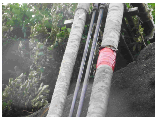
損傷した配管の応急措置
