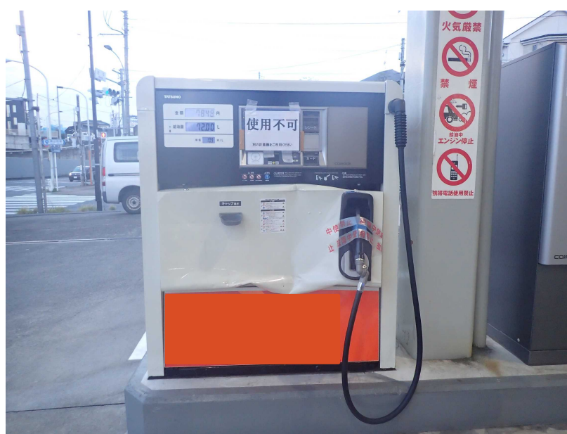
注油設備の破損状況
