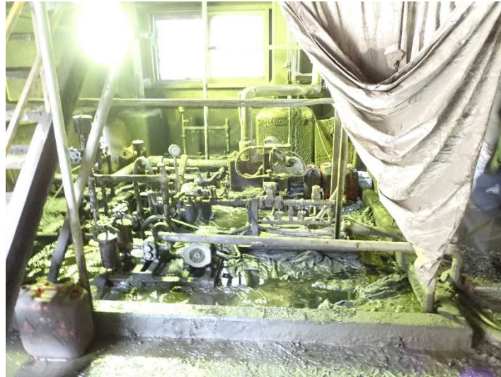
ポンプ設備の状況
