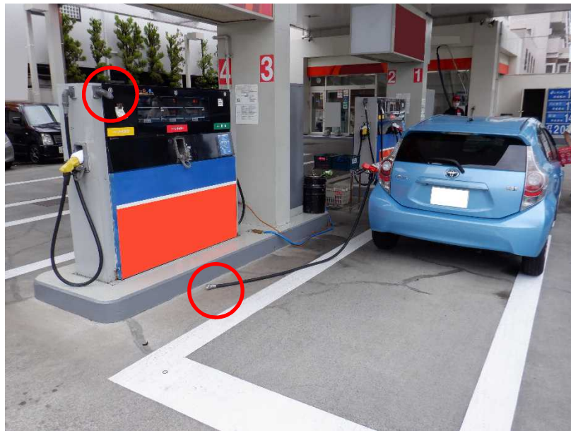
固定給油設備の被害状況
