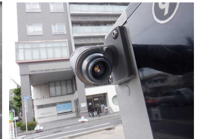
安全継手が作動した状況
