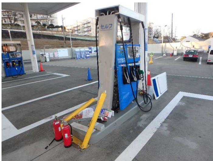
固定給油設備の破損状況
