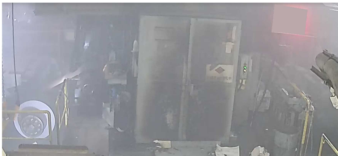
固定式ガス消火設備作動後の状況
