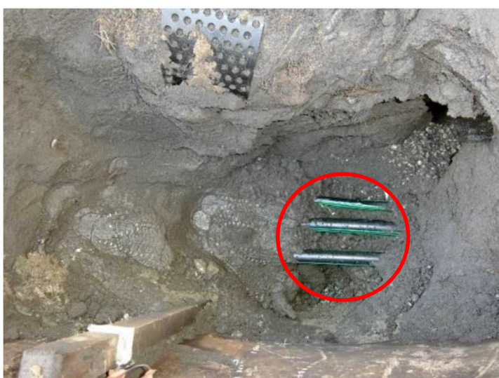
破損した樹脂配管
