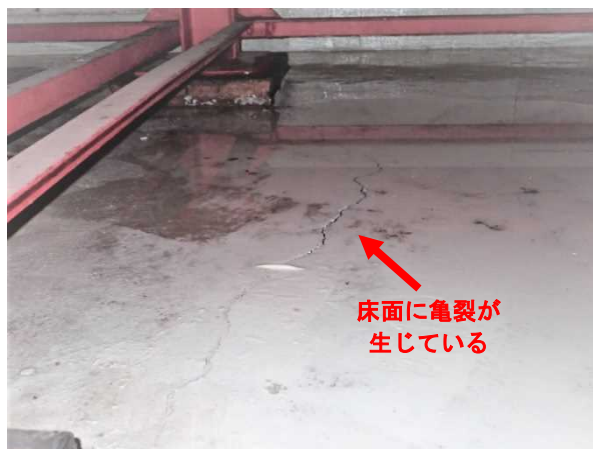
タンク室床面の亀裂の状況
