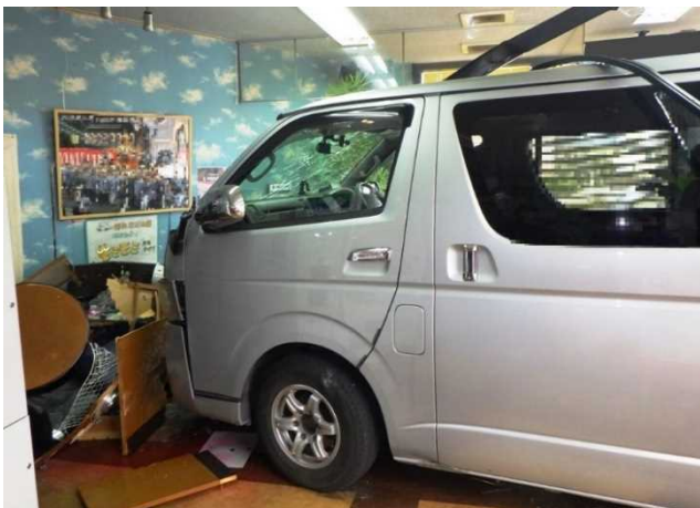
壁に衝突し、外壁まで破損した
