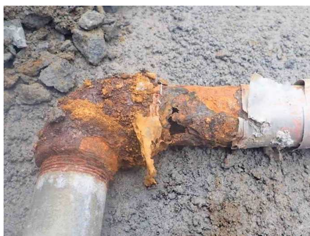
継手部分が特に腐食が進行している
