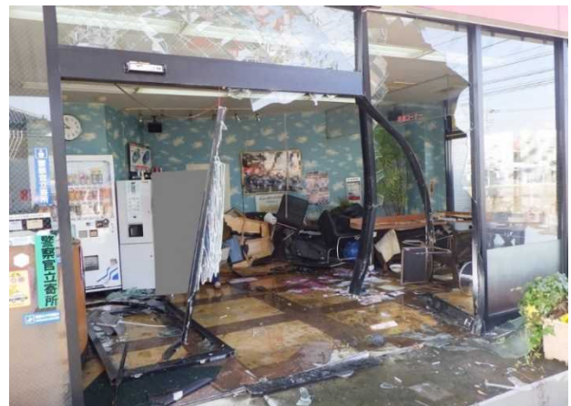
事務所の破損状況
