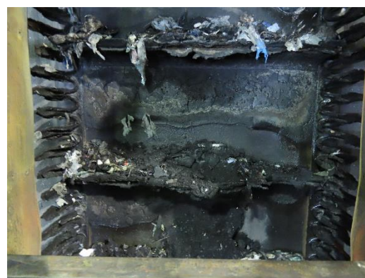
焼損したベルトコンベヤ内部
