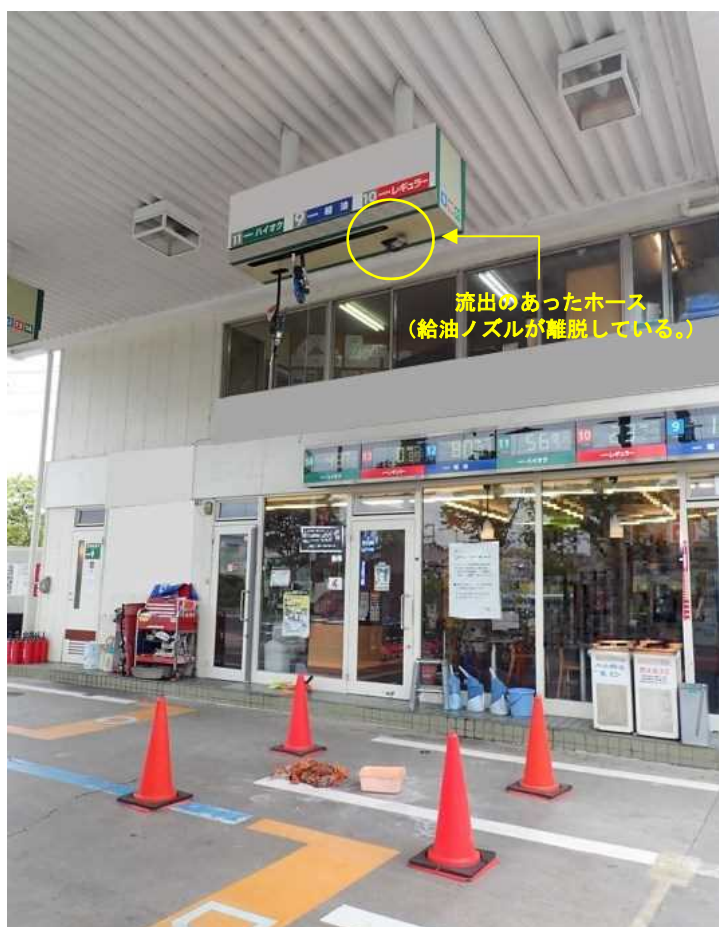
流出のあった懸垂式固定給油設備
