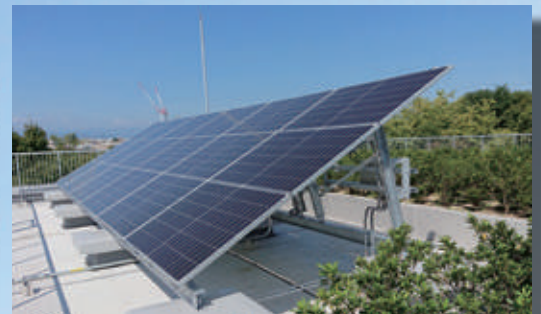
太陽光パネル
