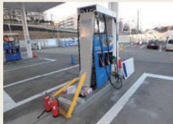
▲ 固定給油設備の破損状況
