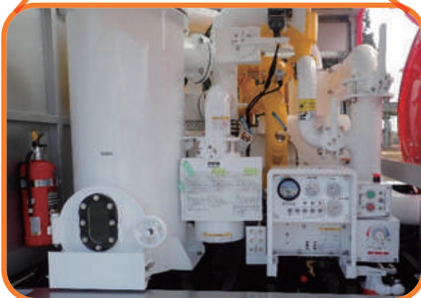
吸引装置操作盤
