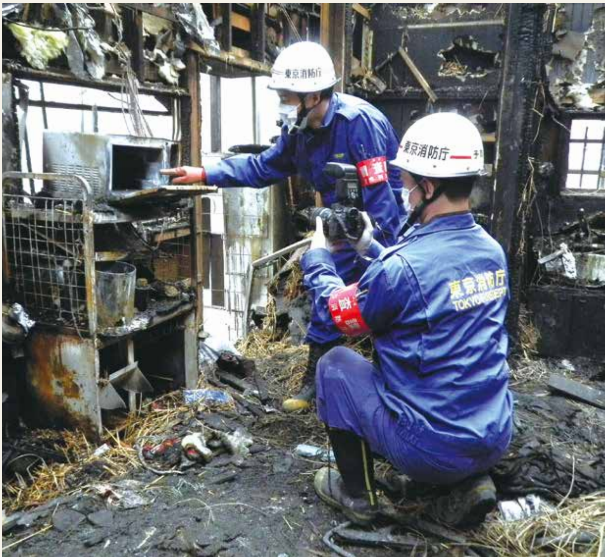
▲ 現場見分の状況
