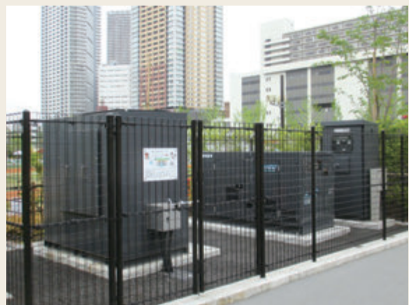
▲ 震災時多機能型深層無限水利 (深井戸)
