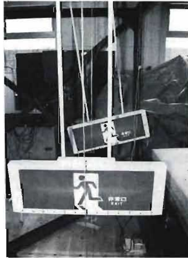
写真5 パイプ上部が外れた状況
