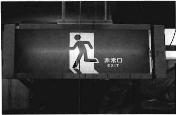
写真2 サイドカバーが左右にずれた状況
