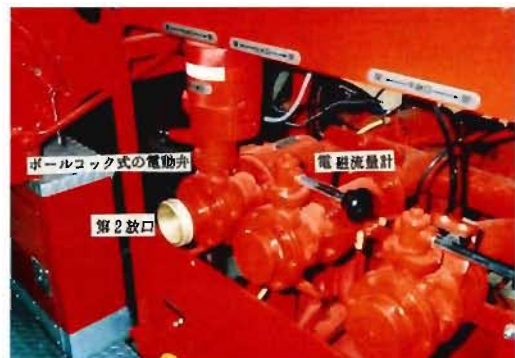
写真4 電動弁と電磁流量計
