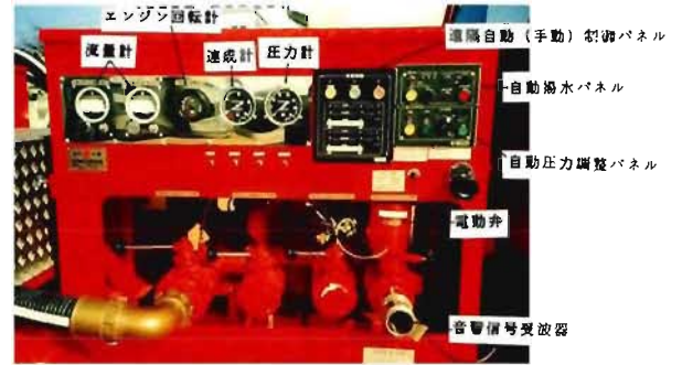
写真2 コントロールパネル
