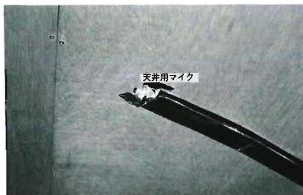
写真1 天井用マイクの設置状況
