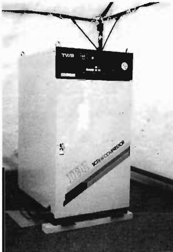
写真14 コンプレッサー
