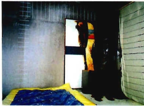
写真10 住宅モデル火災(燃焼後の状況)
