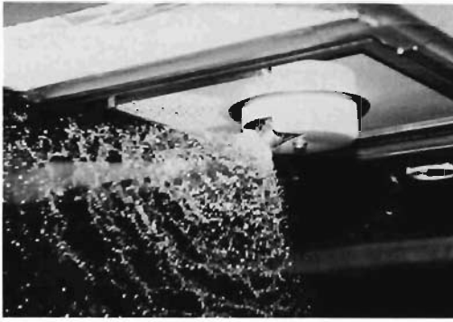
写真3 住宅用スプリンクラー装置 (1軸方式)
